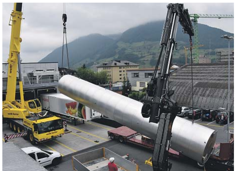
Der 16,5 Meter hohe Wärme-/Kältespeicher fasst 46'000 Liter Wasser und ist gefüllt 51 Tonnen schwer.
